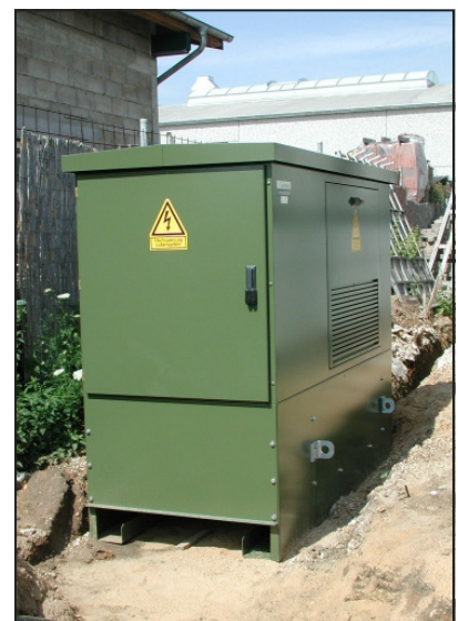
fundamentlos aufgestellte LCS-E
