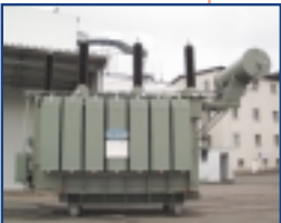
40 MVA 150/10,5 kV ONAN
