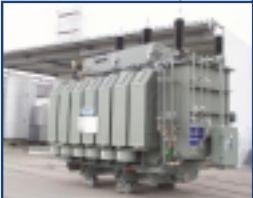
31,5/40 MVA 120/22 kV ONAF
