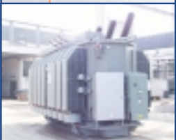
40 MVA 115/21 kV ONAF
