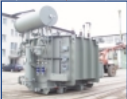
28 MVA 24/1,1 kV OFWF
