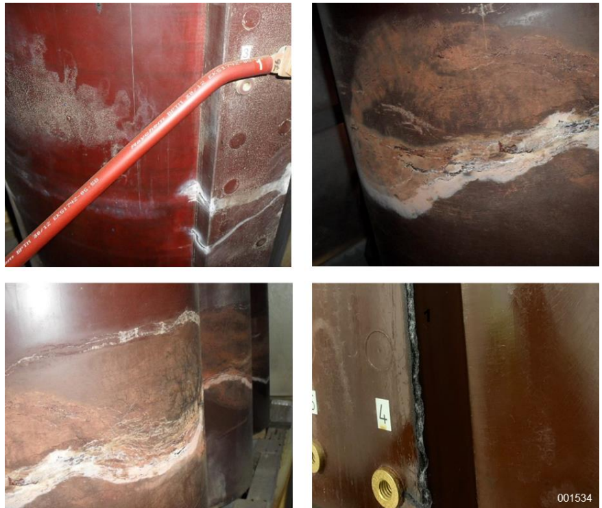
Fig. 24 : Traces de fluage et de décharges partielles
