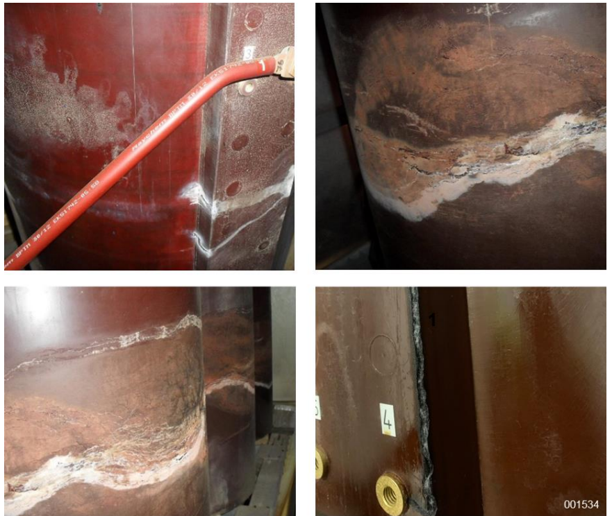
Fig. 24: Marcas de corriente de fuga y de descargas parciales
